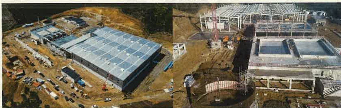
Figura 3 – CVO de biorresíduos da AMBISOUA (situação em dez-24 e jan-24)
